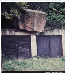
Rock fall - caída de bloque: Ejemplo de Alemania. véase en grande
